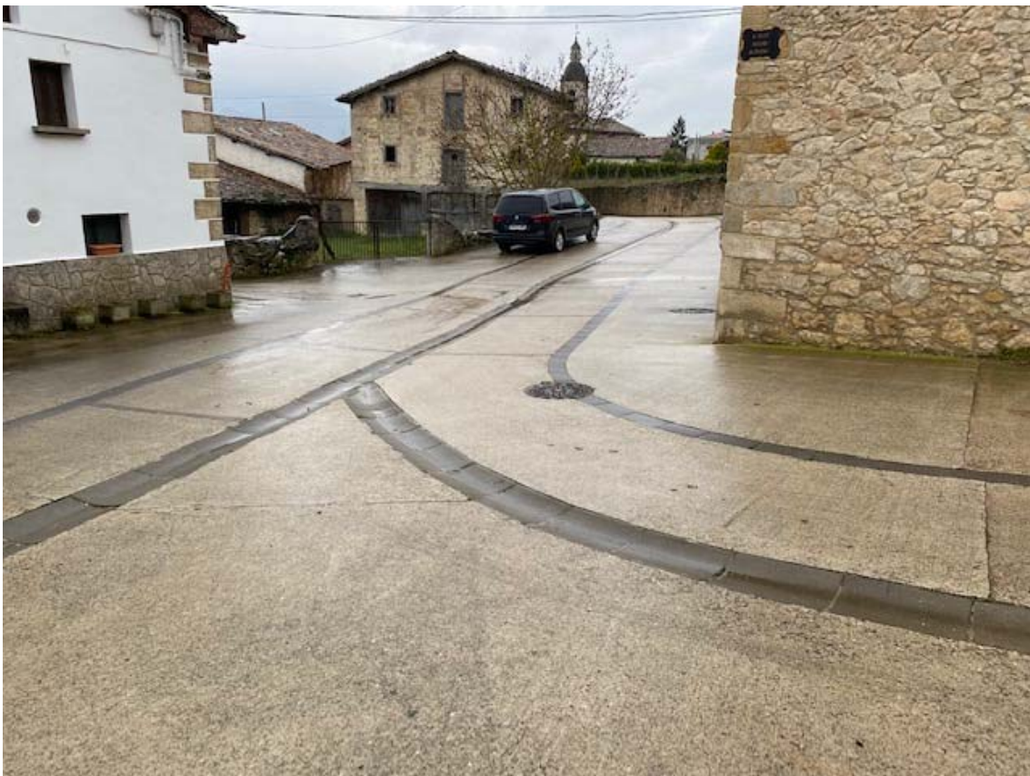
Acometida de aguas pluviales del camino de acceso a la parcela 357 del polígono 1.
